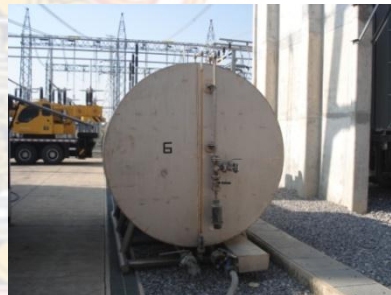
รูปที่ 5 ถังน้ำมัน (Oil Storage Tank)
