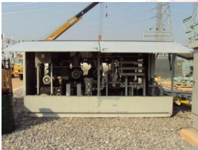
รูปที่ 4 เครื่องกรองน้ำมัน (Oil Purifier)
