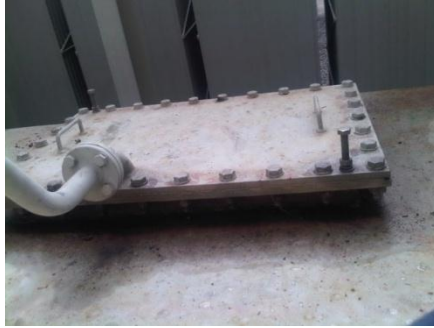
รูปที่ 3 น้ำมันรั่วซึมที่ ฝา Main hole
