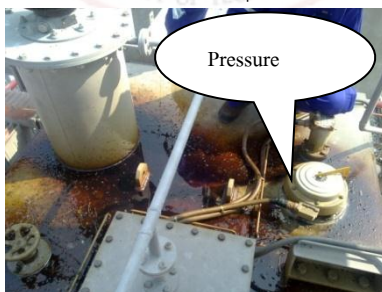
รูปที่ 2 น้ำมันรั่วซึมที่ Pressure Relief
