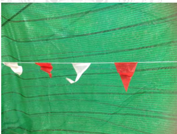
รูปที่ 4.7 กั้นเขตด้วยธงราว หรือแถบขาวแดง แสดงเขตพื้นที่ทำงาน
