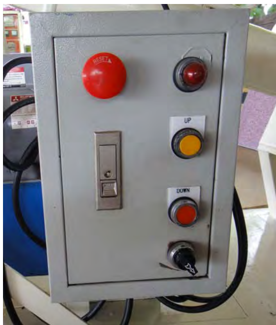
ภาพที่ 3-16 แสดงกล่องควบคุมการทำงานของเครื่อง
