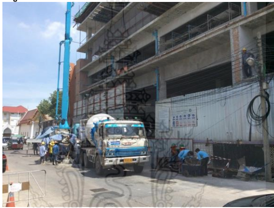
รูปที่ 4.5 ไม่ติดตั้งหลังคาคลุมทางเดินโครงการก่อสร้างที่ติดกับทางสัญจรสาธารณะ
