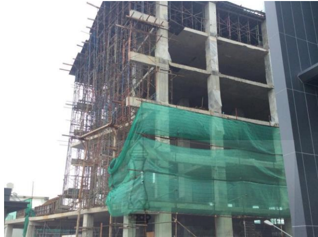
รูปที่ 4.7 ไม่ติดตั้งราวกันตกสูงไม่น้อยกว่า 0.90 ม. โดยรอบอาคารที่ยังไม่ได้ติดตั้งผนัง
