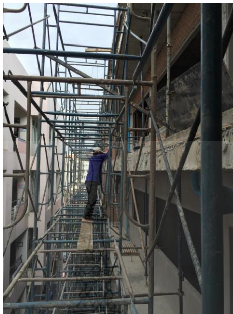
รูปที่ 4.9 คนงานที่ทำงานบนที่สูงไม่ใส่เข็มขัดนิรภัย
