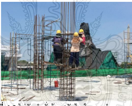
รูปที่ 4.2 ไม่จัดทำนั่งร้าน/บันได ในการทำงานบนที่สูง
