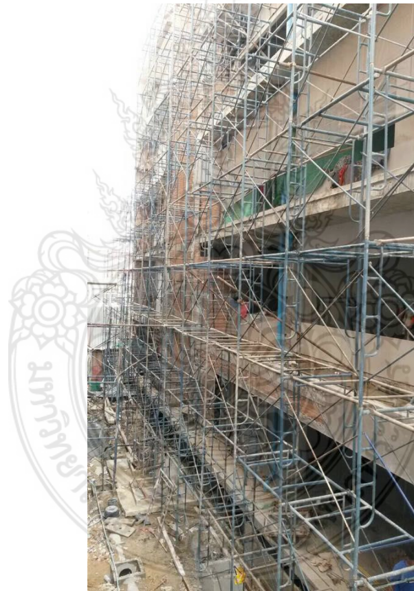
รูปที่ 4.8 การทำงานบนนั่งร้านที่ไม่มีมาตรการป้องกันอันตราย
