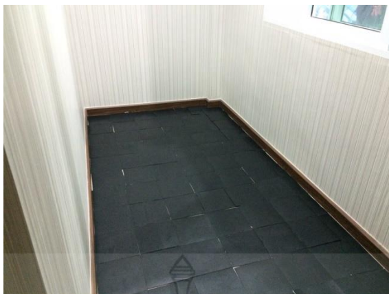
รูปที่ 4.26 ลักษณะการติดตั้งแผ่นกระเบื้องยางพาราผสมพลาสติกอีวีเอที่อัตราส่วน 10 พีเอชอาร์
