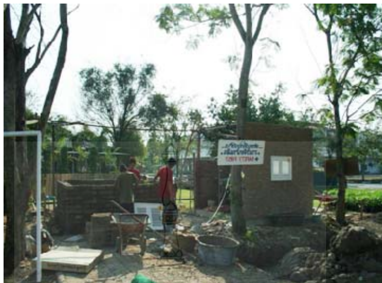
รูปที่ 18 บริเวณสถานที่ก่อสร้างงานวิจัยบ้านดิน ณ อาคารอนุรักษ์พลังงานและสิ่งแวดล้อม ภาควิชาวิศวกรรมโยธา คณะวิศวกรรมศาสตร์ มหาวิทยาลัยเทคโนโลยีราชมงคลธัญบุรี
