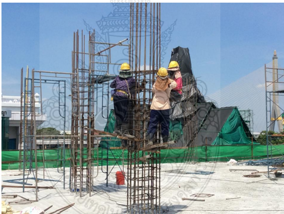
รูปที่ 1.1 สภาพการทำงานติดตั้งเหล็กเสริมเสาที่ไม่ปลอดภัย
