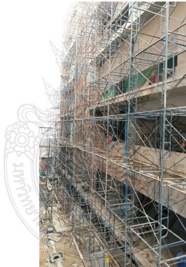
รูปที่ 4.8 การทำงานบนนั่งร้านที่ไม่มีมาตรการป้องกันอันตราย
