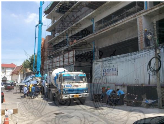
รูปที่ 4.5 ไม่ติดตั้งหลังคาคลุมทางเดินโครงการก่อสร้างที่ติดกับทางสัญจรสาธารณะ
