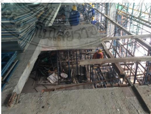
รูปที่ 4.3 ช่องเปิดที่ไม่มีมาตรการป้องกันอันตราย
