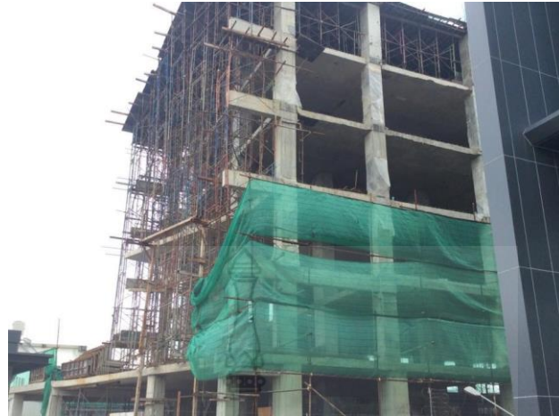
รูปที่ 4.7 ไม่ติดตั้งราวกันตกสูงไม่น้อยกว่า 0.90 ม. โดยรอบอาคารที่ยังไม่ได้ติดตั้งผนัง
