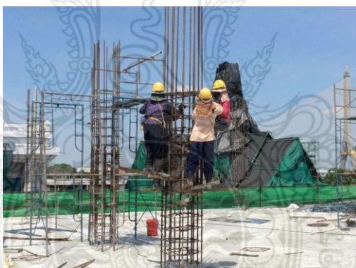
รูปที่ 4.2 ไม่จัดทำนั่งร้าน/บันได ในการทำงานบนที่สูง
