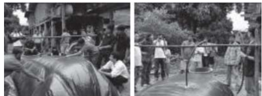
รูปที่ 11 แสดงการประกอบสายส่งแก๊ส พร้อมทั้งติดตั้งขวดปรับแรงดันและดักน้ำ
