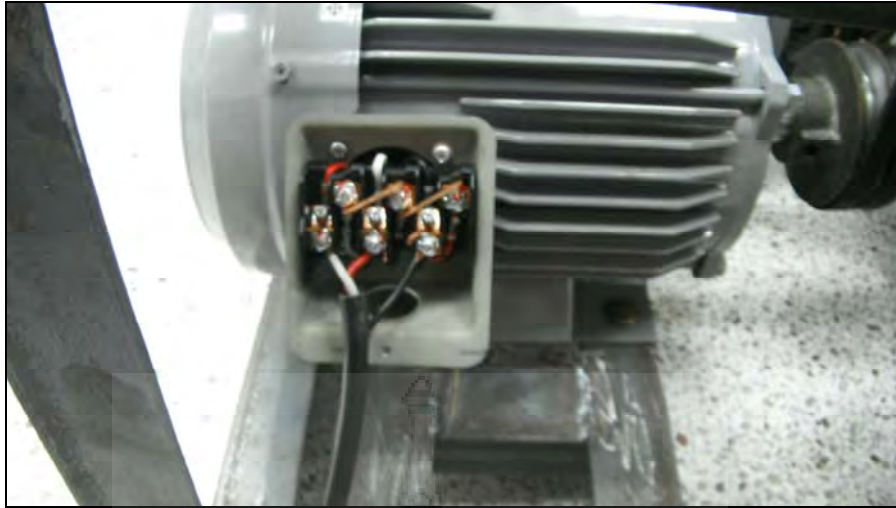
ภาพที่ 3-17 แสดงการต่อสายไฟเข้าเพื่อทดสอบการทำงานเบื้องต้น
