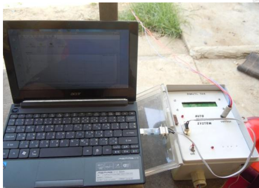
รูปที่ 14 ชุดควบคุมระบบให้น้ำและระบบติดตามดวงอาทิตย์
