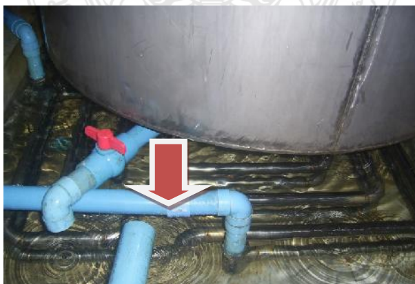
รูปที่ 1 เครื่องแลกเปลี่ยนความร้อน
