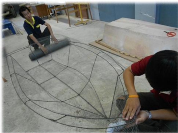
รูปที่ 4 โครงเหล็กเสริมภายในของเรือคอนกรีต
