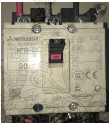
รูปที่ 3.15 สวิตช์เบรกเกอร์หลักตำแหน่ง ON
