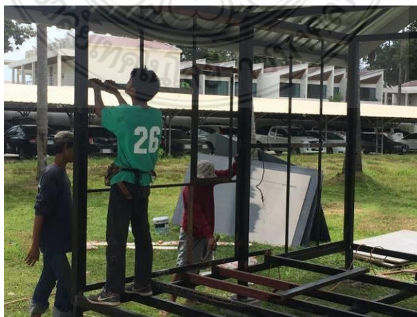
รูปที่ 4.48 การติดตั้งโครงผนังเข้ากับคานและเสาของบ้านถอดประกอบ
