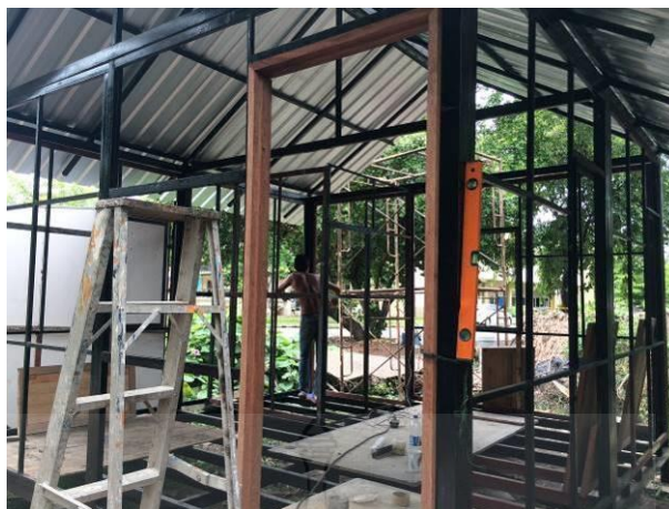
รูปที่ 4.22 การใช้ระดับน้ำเพื่อตรวจสอบแนวตั้งของโครงสร้างบ้านถอดประกอบที่ขนส่งสะดวก
