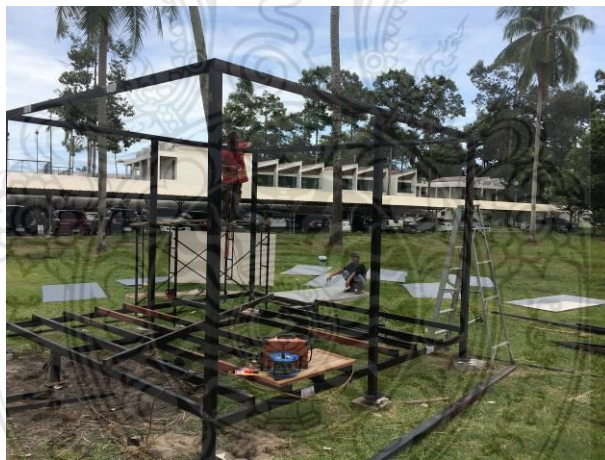
รูปที่ 15 โครงสร้างบ้านถอดประกอบที่มีการติดตั้งคาน ตง ช่อ และอะเส เรียบร้อยแล้ว
