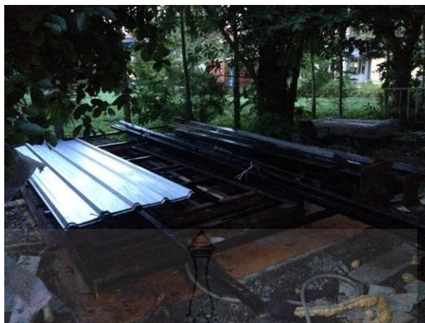
รูปที่ 4.25 กองโครงสร้างบ้านถอดประกอบที่เก็บไว้เพื่อนำไปประกอบ
