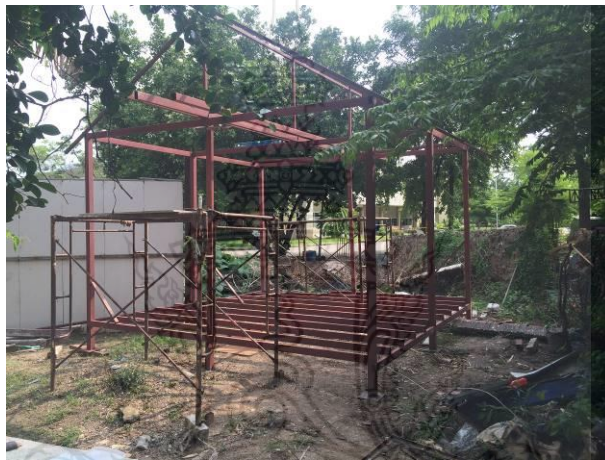
รูปที่ 8 การประกอบส่วนของโครงหลังคา ทั้งตั้ง ออกไก่ และจันทัน
