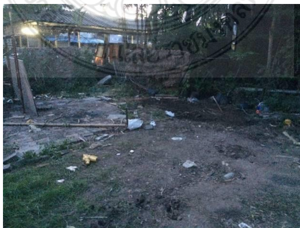
รูปที่ 4.24 การรื้อถอนโครงสร้างบ้านถอดประกอบเรียบร้อยแล้ว
