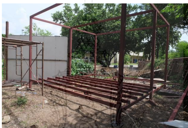
รูปที่ 4.17 การประกอบตงเหล็กเพื่อรองรับแผ่นพื้นของโครงสร้าง
