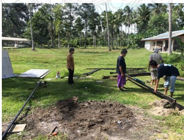
รูปที่ 4.37 การปรับพื้นที่ก่อสร้างบ้านถอดประกอบให้เรียบ
