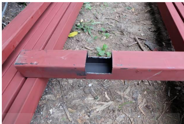
รูปที่ 4.7 การบากเสาเหล็กให้เป็นร่องเพื่อติดตั้งส่วนของคานเหล็ก
