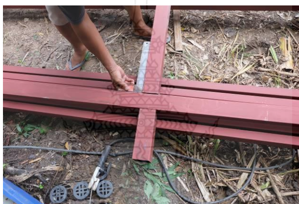
รูปที่ 4.8 การทดลองวางแนวคานเหล็กลงในเสาเหล็กที่บากร่องไว้
