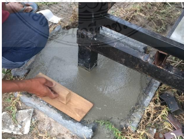
รูปที่ 4.40 การเทฐานรากหุ้มแผ่นเหล็กและโคนเสาตอม่อเหล็กด้วยคอนกรีตเสริมเหล็ก
