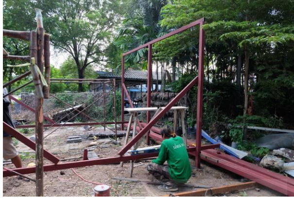
รูปที่ 7 การตั้งเสาเหล็กและคานเหล็กให้ได้ระดับ
