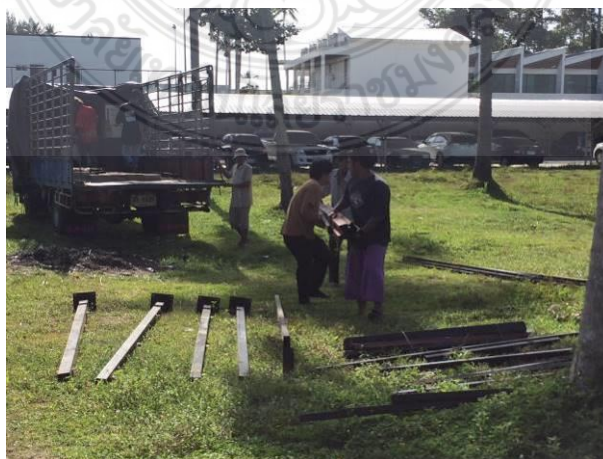
รูปที่ 4.34 การนำโครงสร้างบ้านถอดประกอบลงจากรถบรรทุก 6 ล้อ
