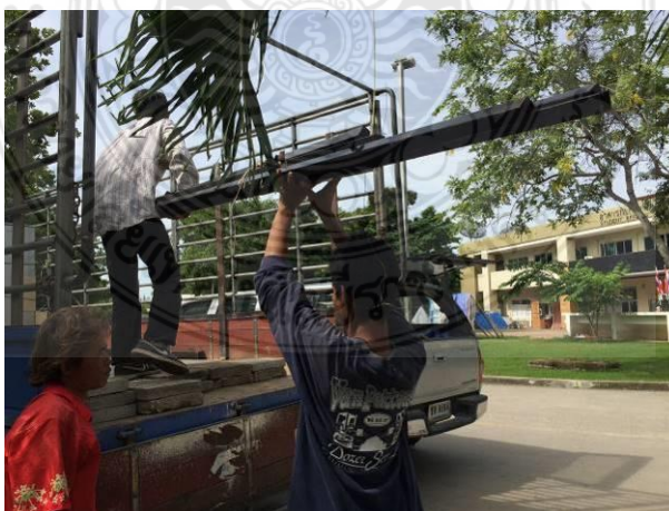
รูปที่ 4.28 การยกโครงสร้างคานและตงของบ้านถอดประกอบขึ้นรถบรรทุก 6 ล้อ
