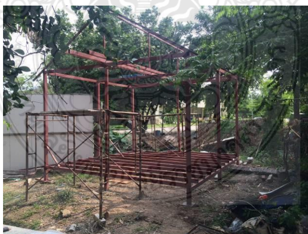
รูปที่ 4.18 การประกอบส่วนของโครงหลังคา ทั้งดั่ง ออกไก่ และจันหัน
