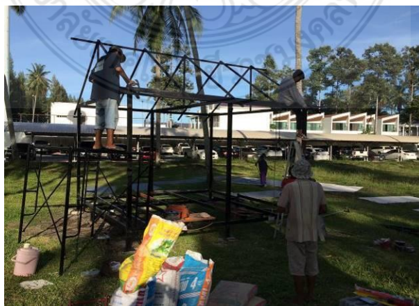
รูปที่ 4.45 การติดตั้งดั่ง ออกไก่ และจันทันของโครงหลังคาเรียบร้อยแล้ว
