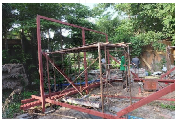
รูปที่ 4.14 การประกอบส่วนของอะเสเหล็กลงบนเสาเหล็กทั้ง 3 เสา
