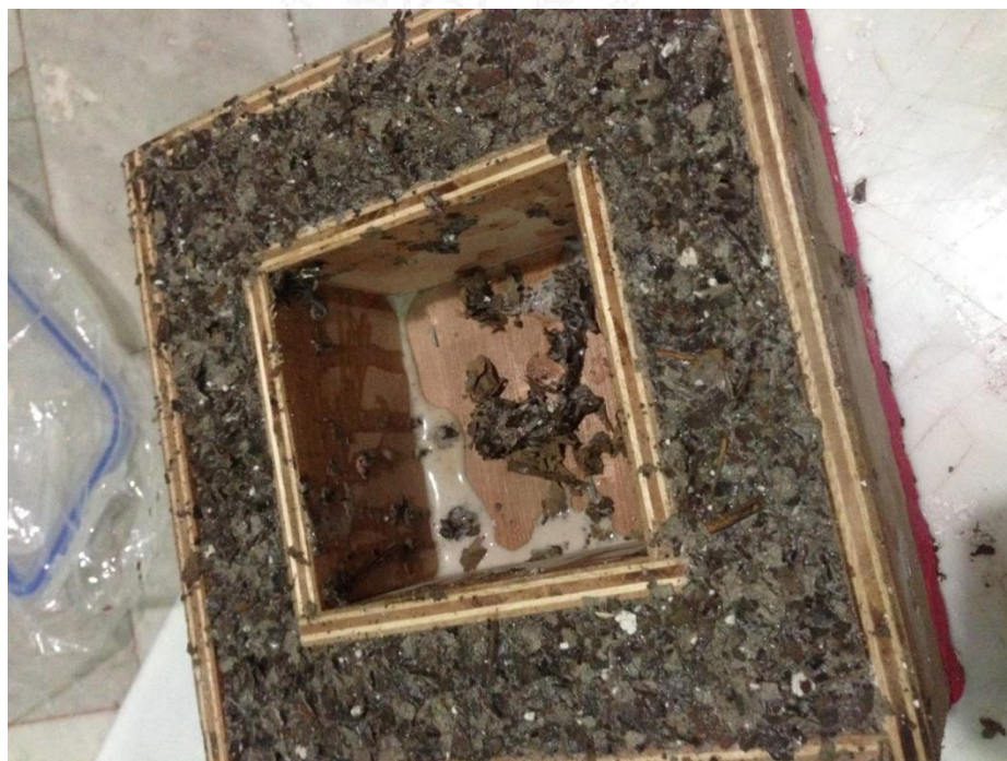
ภาพที่ 4.13 แสดงภาพการอัดส่วนผสมใบสักกับวัสดุประสานลงในบล็อกของผนังปลุกพืชจากใบสักเพื่อเป็นฉนวนกันความร้อนให้กับอาคาร
