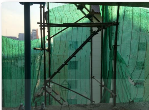
รูปที่ 4.8 บันไดชั่วคราวที่ไม่ติดตั้งราวกันตก
