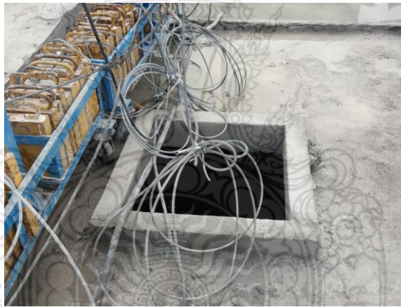
รูปที่ 4.3 ช่องเปิดที่ไม่มีมาตรการป้องกันอันตราย
