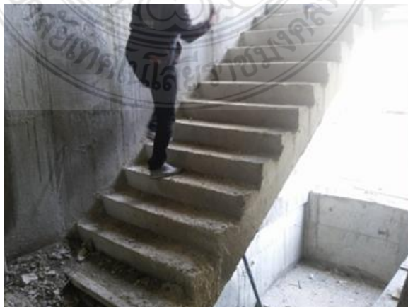
รูปที่ 4.4 บันไดถาวรที่ไม่ติดตั้งราวกันตกชั่วคราว
