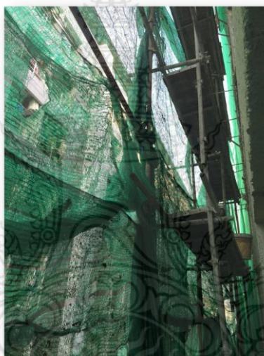
รูปที่ 4.9 ทางเดินบนนั่งร้านที่ไม่มีมาตรการความปลอดภัย
