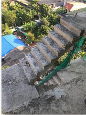
รูปที่ 4.5 บันไดถาวรที่ไม่ติดตั้งราวกันตกชั่วคราว
