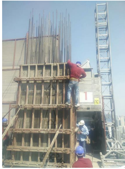
รูปที่ 4.2 ไม่จัดทำนั่งร้าน/บันได ในการทำงานบนที่สูง
