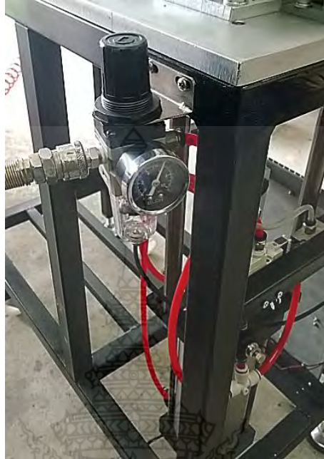
รูปที่ 3.23 ระบบนิวแมติกและชุดวาล์วควบคุม
