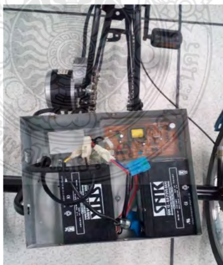
รูปที่ 4.11 ชุดควบคุมมอเตอร์
