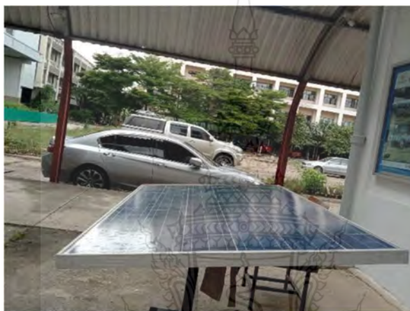
รูปที่ 4.2 การติดตั้งแผงโซลาร์เซลล์ทำมุมที่ 15 องศา
