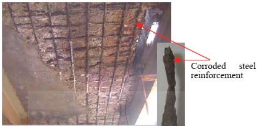
รูปที่ 2.3 ความเสียหายของโครงสร้างคอนกรีตเนื่องจากการเกิดสนิมของเหล็กเสริม
