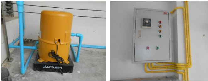
รูปที่ 3 ปัมป์หมุนเวียนน้ำและกล่องควบคุม
