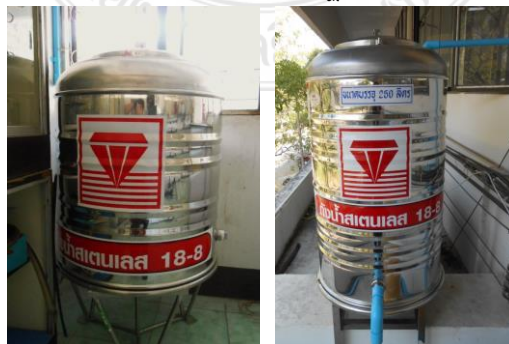
รูปที่ 2 แทงค์น้ำหมุนเวียนในระบบ
