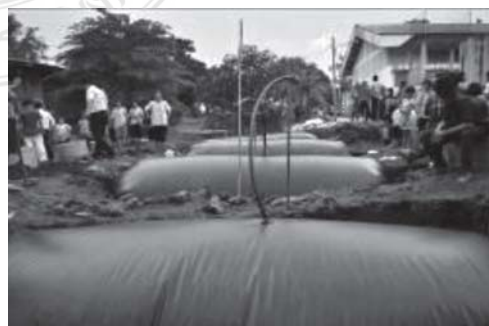
รูปที่ 11 บ่อแก๊สชีวภาพที่ติดตั้งแล้วเสร็จพร้อมใช้งาน
