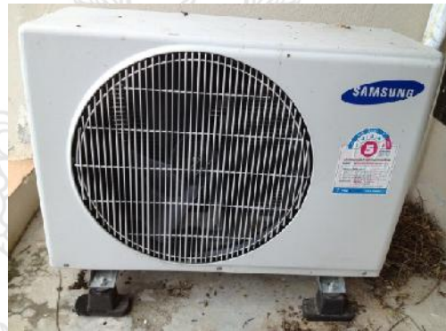
รูปที่ 3 คอยล์ร้อนติดตั้งภายนอกอาคาร
