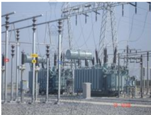
ภาพ 2.1 แปลงไฟฟ้ากำลังขนาด 200 MVA สถานีไฟฟ้าแรงสูงท่าวัง การไฟฟ้าฝ่ายผลิตแห่งประเทศไทย
