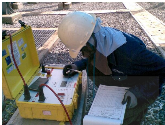
ภาพ 4.2 ทดสอบอัตราส่วนของขดลวดของหม้อแปลงไฟฟ้า
