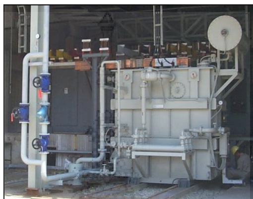
ภาพ 2.6 แสดงลักษณะของหม้อแปลงไฟฟ้าชนิดพิเศษ
