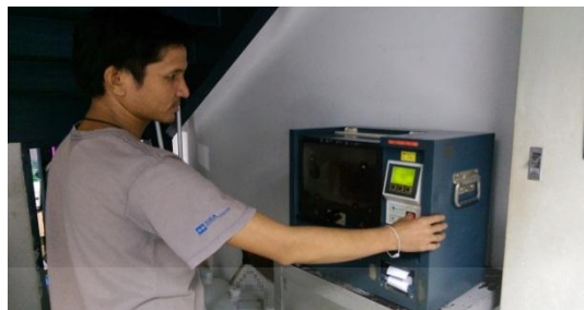
ภาพ 4.10 วัดค่าความเป็นฉนวนของน้ำมันหม้อแปลง
