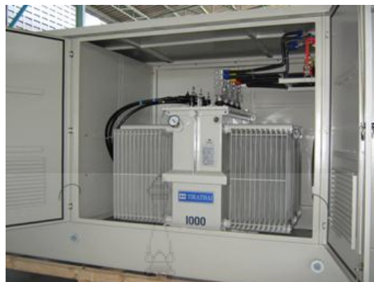
ภาพ 2.4 หม้อแปลงชนิด Less-flammable Liquid Type (Silicone fluid)
