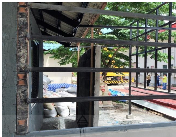
รูปที่ 4.16 โครงคร่าวเหล็กสำหรับติดตั้งแผ่นซีเมนต์บอร์ดจากเก้าะลามะพร้าว
