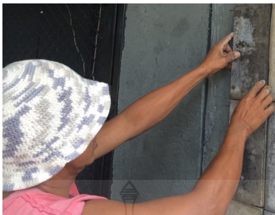
รูปที่ 4.19 การติดตั้งแผ่นซีเมนต์บอร์ดจากเก้าะลามะพร้าวที่ผ่านการตัดให้เล็กเพื่อเข้ามุมผนัง
