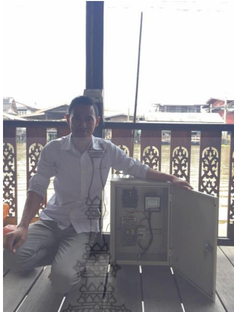
ภาพ 3.25 จุดติดตั้งชุดตรวจวัดและแจ้งเตือนค่าน้ำเค็ม สถานีวัดบางอ้อยช้าง
