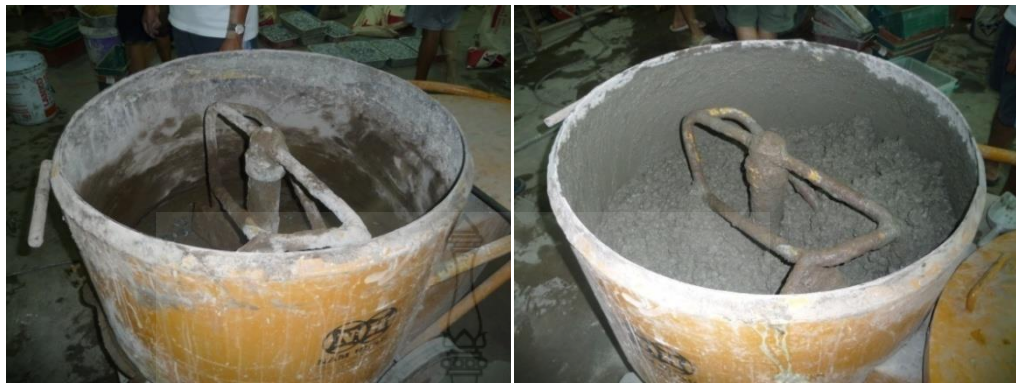
การผสมคอนกรีตตามส่วนผสมที่ชั่งน้ำหนักไว้แล้ว
