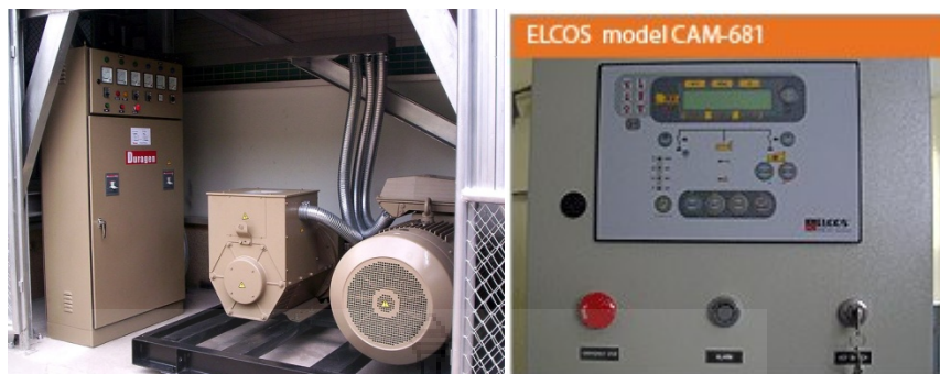
รูปที่ 2.36 อุปกรณ์ควบคุมและเครื่องกำเนิดไฟฟ้า
