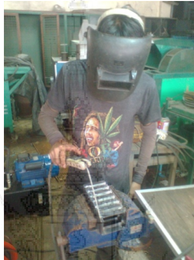
รูปที่ 3.13 การเชื่อม โครงสร้างกันแรงกระแทก
