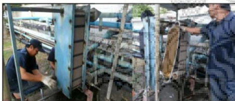
รูปที่ 1 เครื่องแลกเปลี่ยนความร้อนที่มีปัญหาแบบ Plate Heat Exchanger
