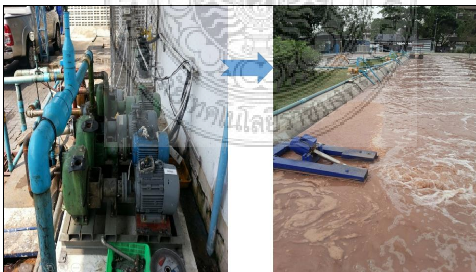
ภาพ 1.4 น้ำเสียจากบ่อพักถูกส่งไปยังบ่อบำบัด มีอุณหภูมิต่ำประมาณ 12-20°C
