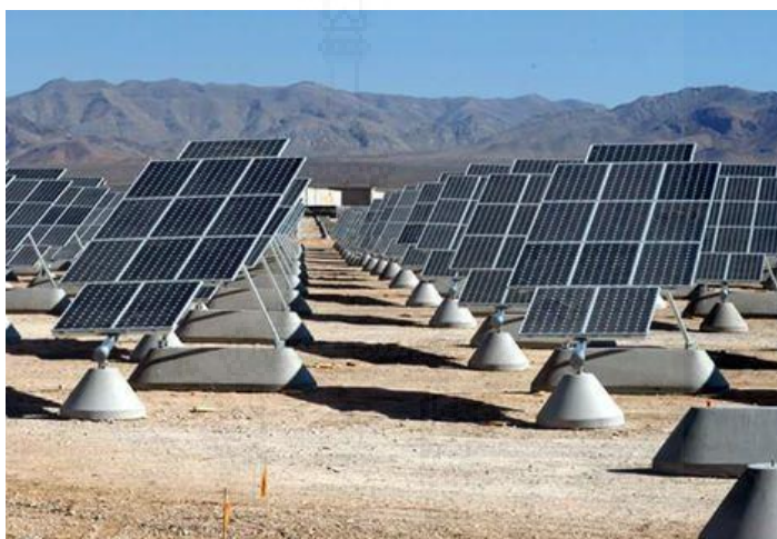
ภาพ 2.10 ผิวแผงพลังงานแสงอาทิตย์ที่ควรมีการตรวจสอบตลอดเวลา
