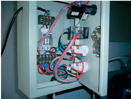
รูปที่ 8 แสดงการติดตั้งระบบไฟฟ้าที่ใช้ควบคุมการทำงานของอุปกรณ์แยกความชื้น
