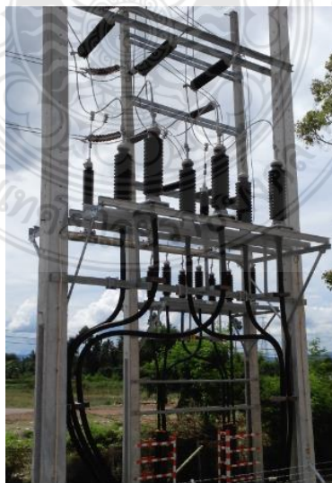
รูปที่ 2.1 เสาต้นขึ้นหัวสายเคเบิลใต้ดินระบบ 115 kV
