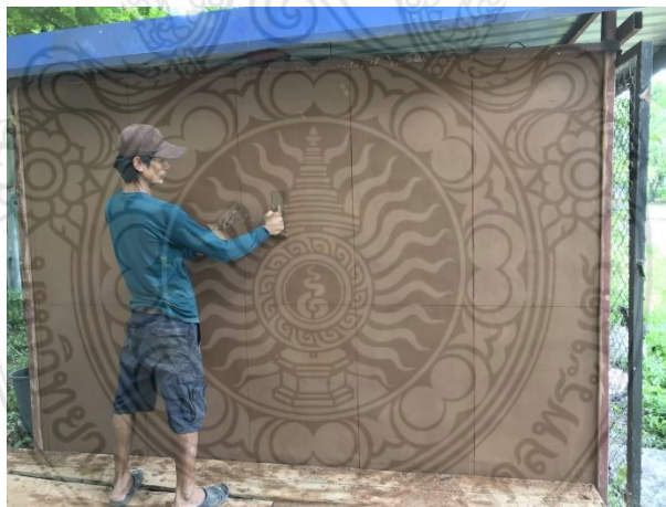
รูปที่ 71 การฉาบปิดร่องของแผ่นผนังบ้านดินสำเร็จรูปผสมน้ำยางพาราให้เรียบ
