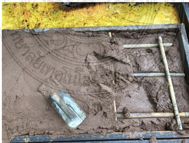
รูปที่ 41 การฉาบตัวอย่างผนังบ้านดินสำเร็จในแบบหล่อขนาด 60x120x15 เซนติเมตร เพื่อหุ้มไม้รวก
