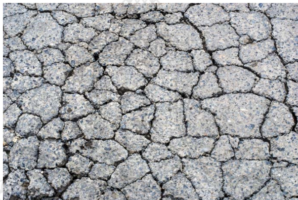
รูปที่ 1.1 ผิวถนนยางมะตอยที่เสียหายจากการใช้งานและสภาพอากาศ
