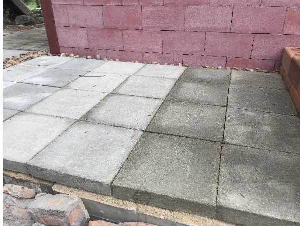
รูปที่ 37 ลักษณะของแผ่นกระเบื้องคอนกรีตปูพื้นผสมเศษถนนยางมะตอยเก่าที่ปูเป็นพื้นรอบอาคาร
