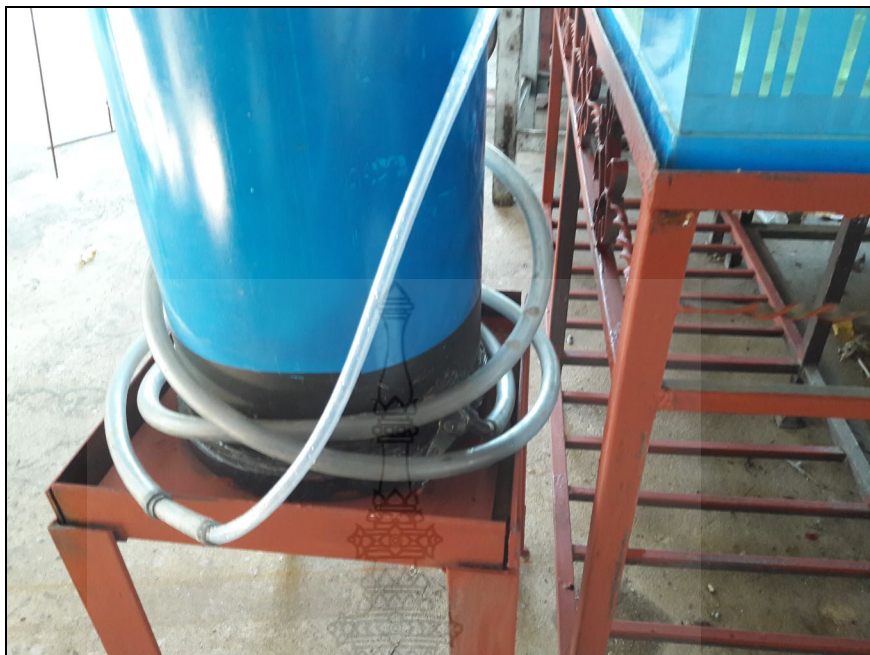
รูปที่ 3-22 แสดงการต่อท่อน้ำออกจากอุปกรณ์เพื่อเข้าอ่างปลา
