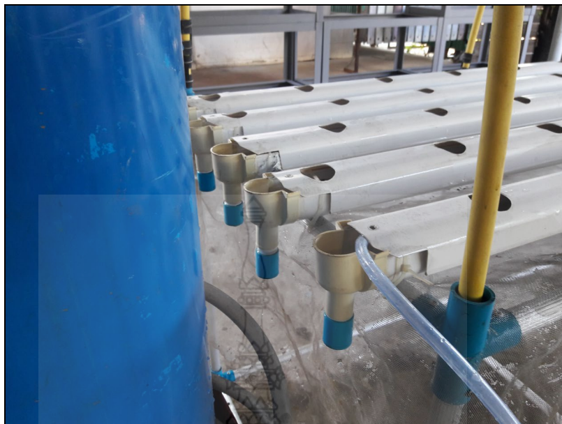
รูปที่ 3-31 แสดงปลายท่อน้ำเข้าร่างระบบปลูกพืชไร้ดิน
