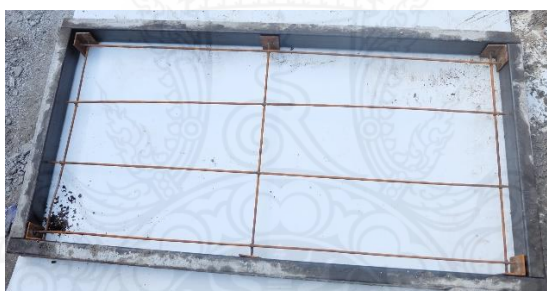
รูปที่ 3.15 การประกอบวางโครงเหล็กเสริมผนังคอนกรีตภายในแบบ
