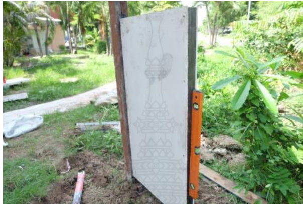
รูปที่ 4.13 การตั้งแนวผนังคอนกรีตผนังคอนกรีตผสมกากดินขามวลรวมละเอียดโดยการใช้ระดับน้ำ
