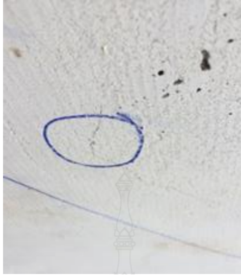
รูปที่ 4.7 ผนังคอนกรีตสำเร็จรูปที่ถูกวัดอุณหภูมิกระแทกจนเกิดรอยร้าว
