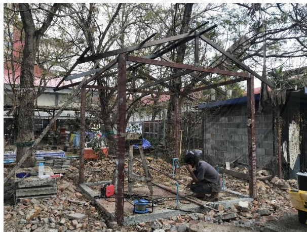
รูปที่ 32 โครงสร้างอาคารขนาด 2.5 x 2.5 เมตร สูง 2.5 เมตร สำหรับก่อผนังด้วยคอนกรีตบล็อกผสมเศษต้นมันสำปะหลัง
