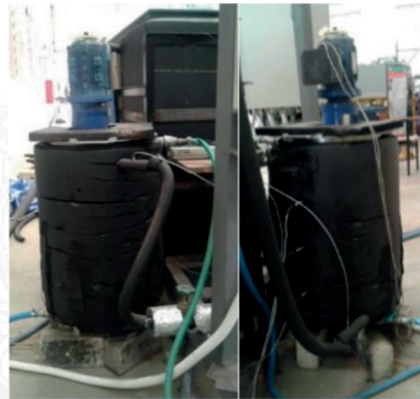
ข) การติดตั้งมอเตอร์ใบกวนกับถังน้ำร้อนรูปที่ 14 มอเตอร์ตีตใบกวนบนถังน้ำร้อน
