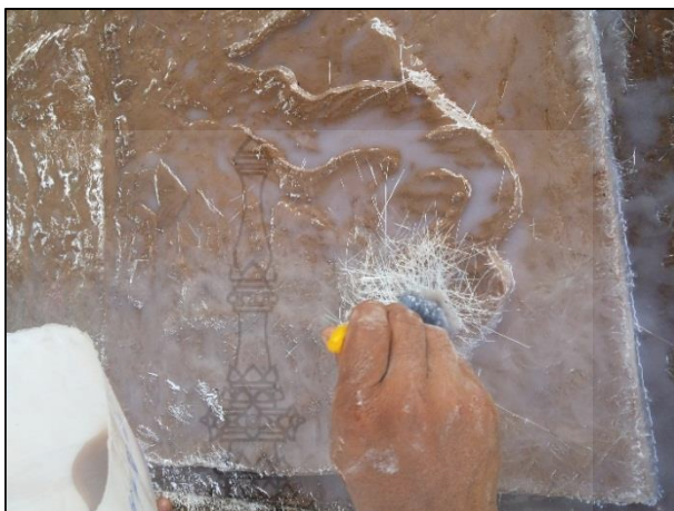
ภาพที่ 3-11 แสดงการวางแผ่นใยแก้วลงบนแม่แบบ
