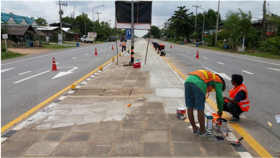
ภาพ 3.10 กรทาสีสะท้อนแสง และติดเป้าสะท้อนแสงที่ขอบเกาะ
