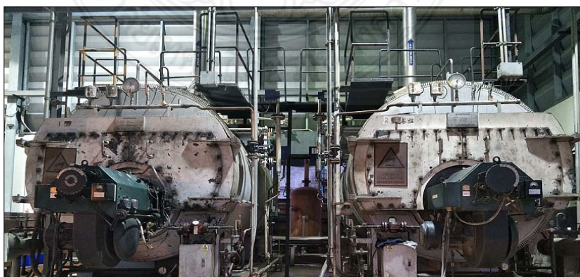
ภาพ 5.2 หม้อน้ำ(Boiler) ขนาด 3 ตันต่อชั่วโมง จำนวน 2 ชุด ขององค์กรกรณีศึกษา
