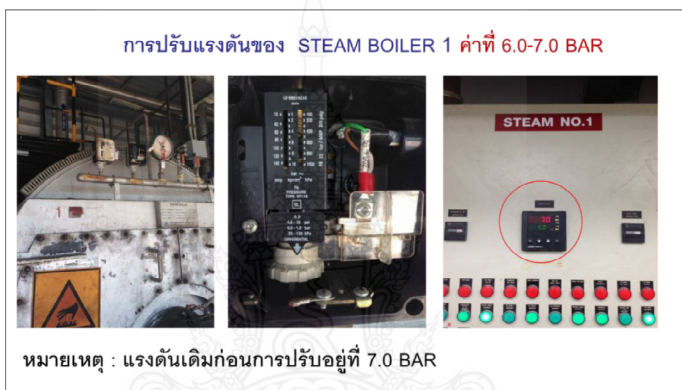
ภาพ 5.3 การปรับแรงดันหม้อน้ำ (Boiler) No. 1 ที่ค่า 6.0-7.0 บาร์
