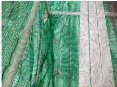
รูปที่ 4.10 การติดตั้งตาข่ายป้องกันอันตรายต่อผู้ทำงานอยู่ด้านล่าง
